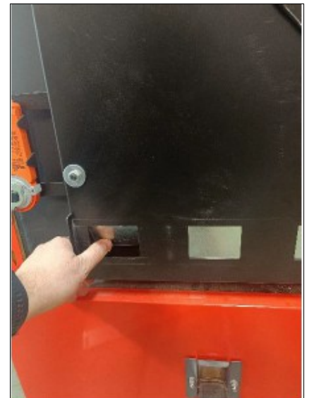
Vérifier que chaque volet s'ouvre bien et qu'aucun colmatage n'est détecté. Le cas échéant, nettoyer les volets d'air.
