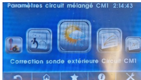
Correction sonde extérieure circuit CM sur ON
